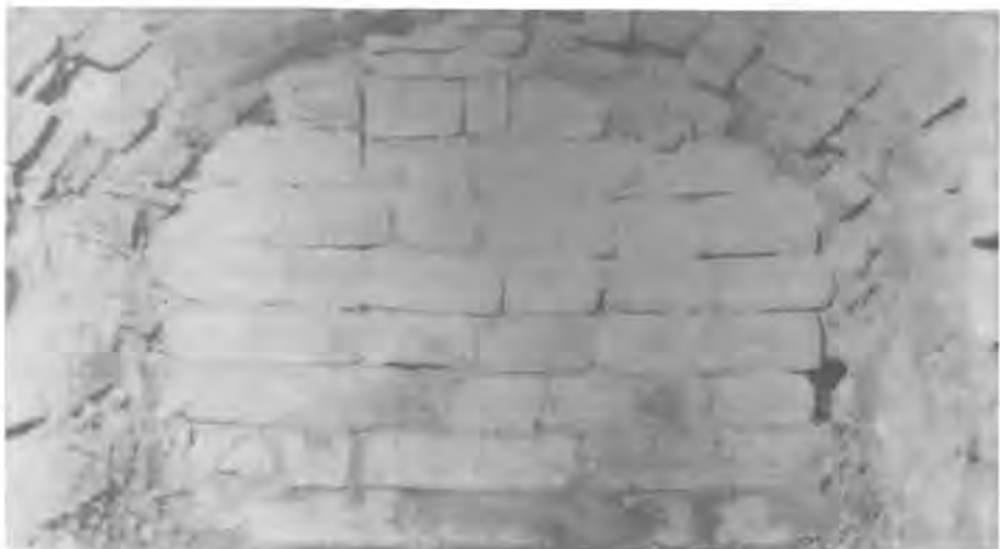
La cloison intérieure entre le gueuloir et le four (vue prise dans le gueuloir)
